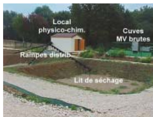
Photo 4 – Lits de séchage plantés de roseaux pour matières de vidange floculées, en cours d'installation à Athée-sur-Cher
