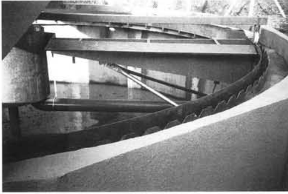
Photo 19 : Trémie radiale de récupération des flottants (SATESE 37)
