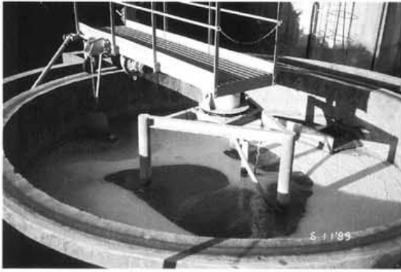
Photo 11 : Dessableur-dégraisseur combiné (SATESE 37)
