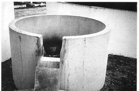
Photo 15 : Ouvrage de dégazage (SATESE 41)
