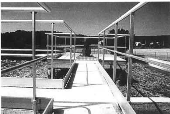
Photo 13 : Bassin d'aération (ARPE-PACA)
