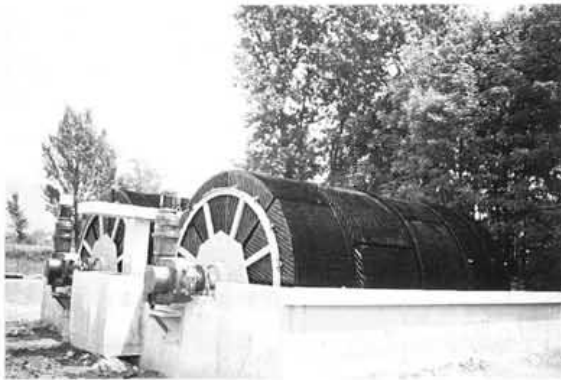
Photo 28 : Disque biologique (en construction) à entraînement central (SATESE 73)
