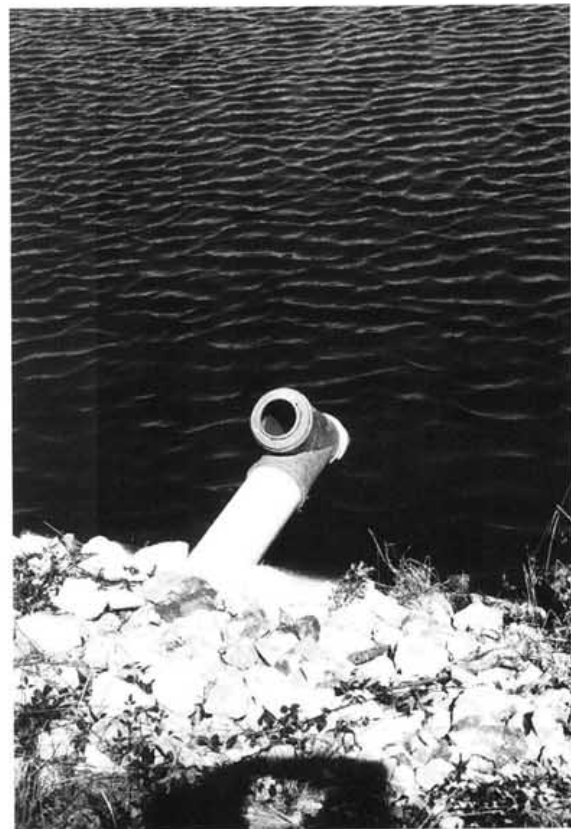
Photo 24 : Dispositif de liaison entre lagunes (SATESE 34)
