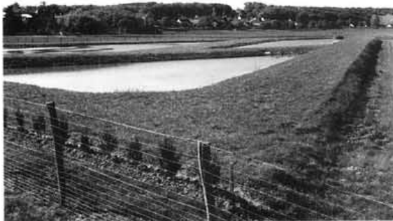
Photo 23 : Bassins de lagunage naturel (SATESE 41)
