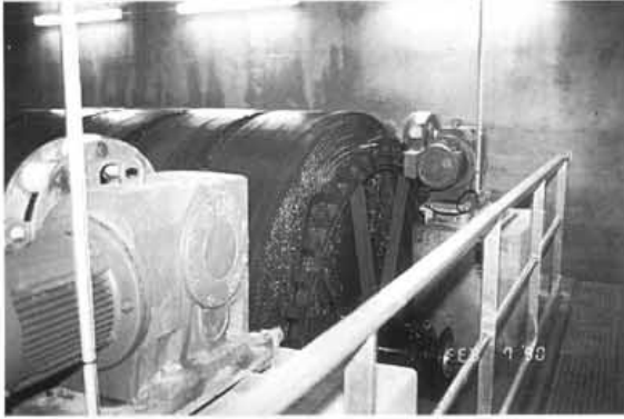
Photo 27 : Disques biologiques à entraînement périphérique (CEMAGREF)
