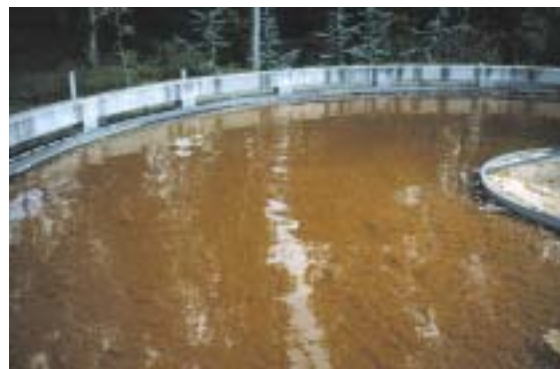
Figure 14– Voile de boue haut dans le clarificateur
