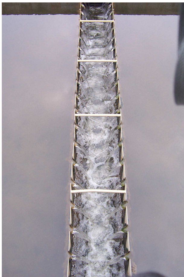
Photo : Goulotte de récupération des eaux décantées
