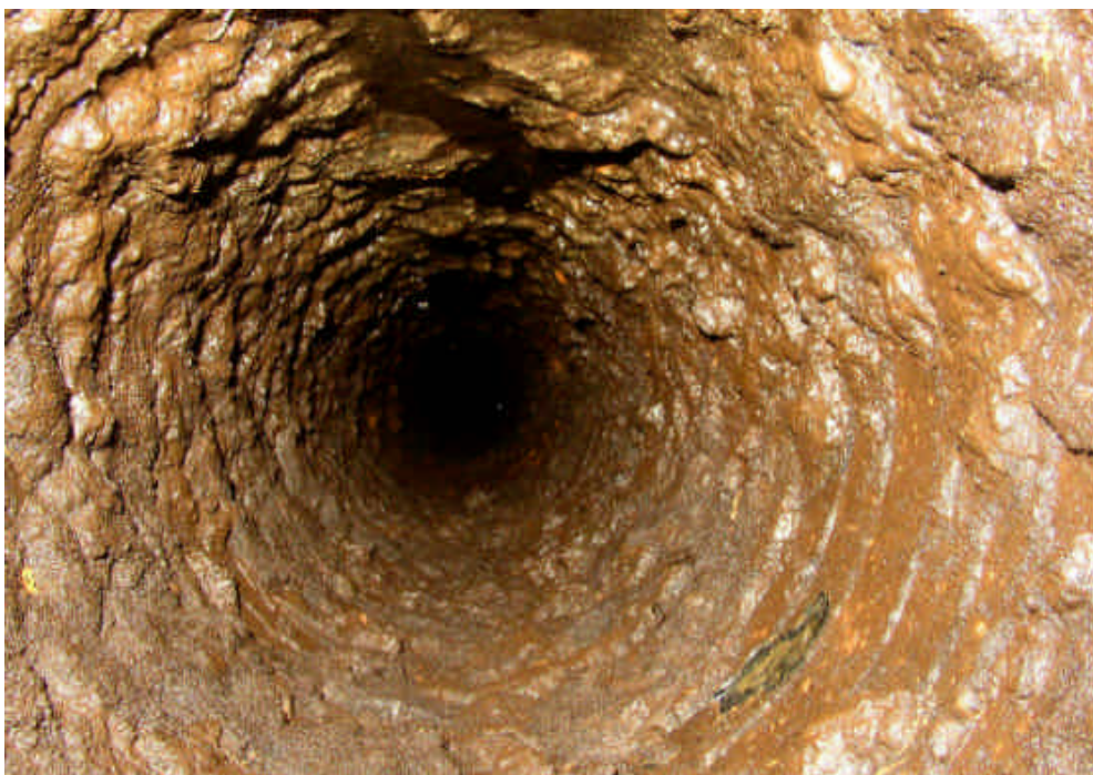
Photographie n°4. Etat d'une canalisation avant nettoyage (Source AXEO)
