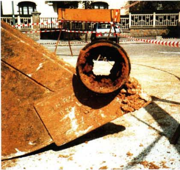
Etat d'une conduite avant intervention (photo NANCIE)
